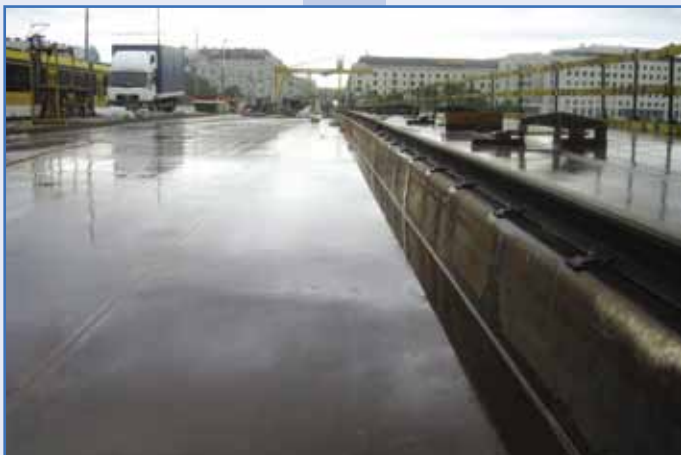
Margit híd korrózióvédelme és szigetelése
