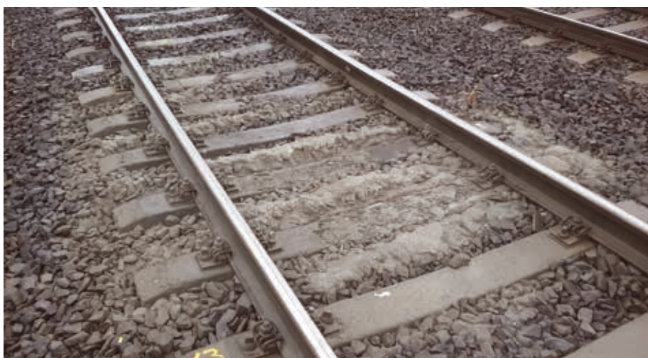
2. kép: Rosszul víztelenített vasúti alépítményre utaló jelek
