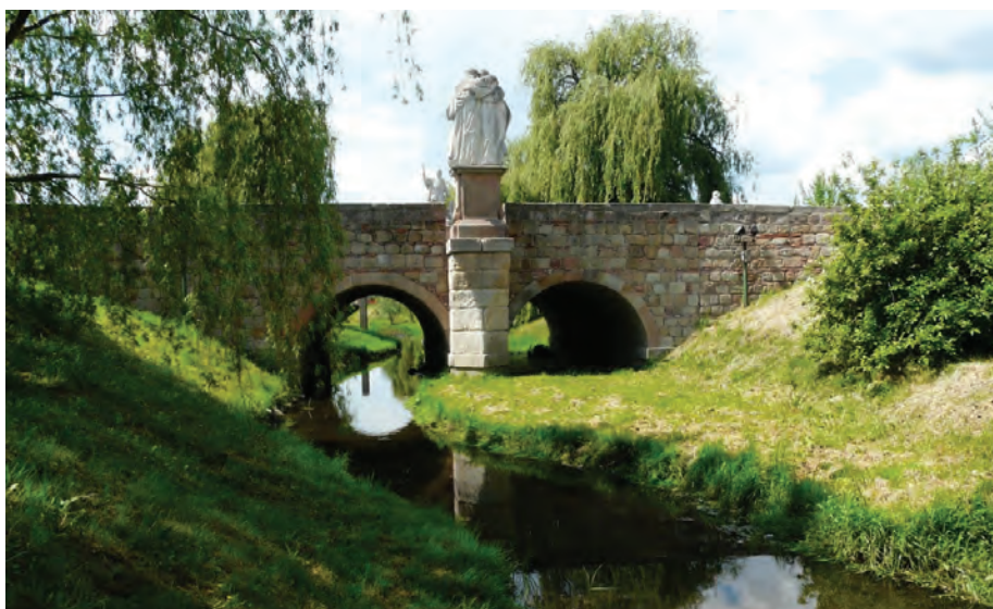
A híd keleti, befolyási oldala, a főlispapolódott északi (Vác felőli) medderrel
