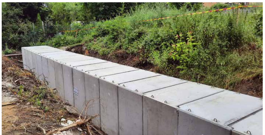
9. kép: A Dubnik patak átvezetését biztosító keretműtárgy elemei már a helyükre kerültek (fotó: Varga Zoltán, A-Híd Zrt.)
